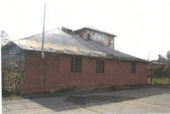
DETALLE DE FACHADA POSTERIOR. CLARAMENTE TIENE LOS MISMOS PROBLEMAS DE MANTENSIION, SUMADO A LA APARICION DE GRAFITIS Y A LA MALA CALIDAD DE LA CUBIERTA.
