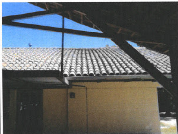
CURVATURA DE ESTRUCTURA DE TECHUMBRE
