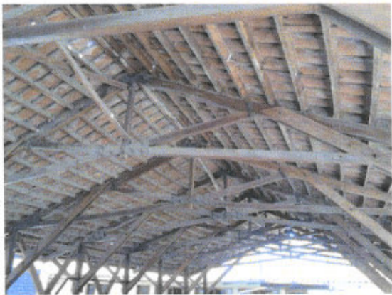
EL PESO DEL DESPLAZAMIENTO DE TEJAS PRODUCTO DEL TERREMOTO, HA HECHO COLAPSAR A SU ESTRUCTURA
