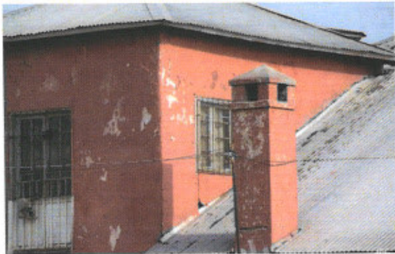
DETALLE DEL ESTADO DE PINTURA EN MUROS EXTERIORES, LA EXPOSICION A LA INTERPERIE Y FALTA DE MANTENSIION DA COMO RESULTADO ESTA APARIENCIA DE ABANDONO Y DETERIORO, SIN EMBARGO ES UNA SITUACION SUPERFICIAL.
